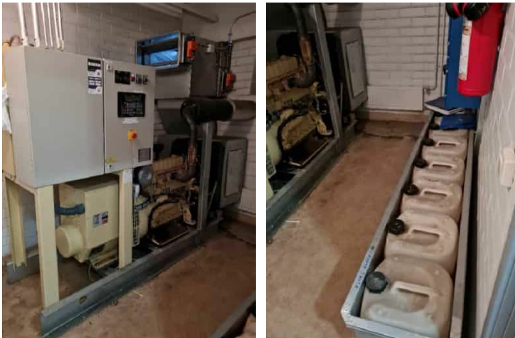
Kuva 6. Varavoimakone ja polttoainekanisterit.
